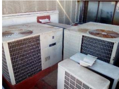
Imagen 15. Unidades Roof-Top instalación de climatización (fuera de funcionamiento)
