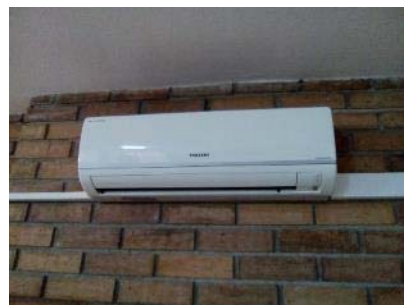
Imagen 14. Unidad interior tipo Split de pared
