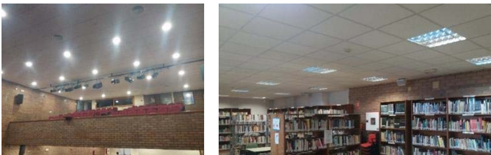
Imagen 8. Luminarias instaladas en el centro
