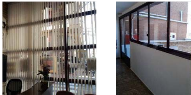
Imagen 4. Dispositivo interior de control solar
