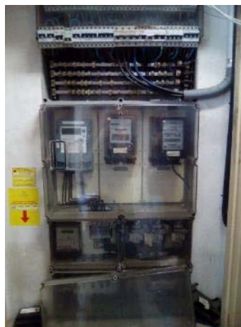
Imagen 20. Cuadro General de Baja Tensión
