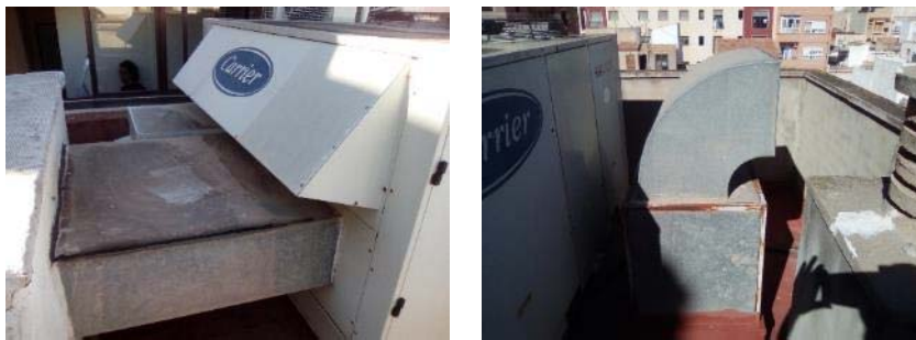
Imagen 10. Unidad Roof-top Carrier
